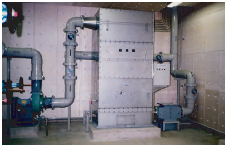
レジャー施設（合併処理浄化槽）
