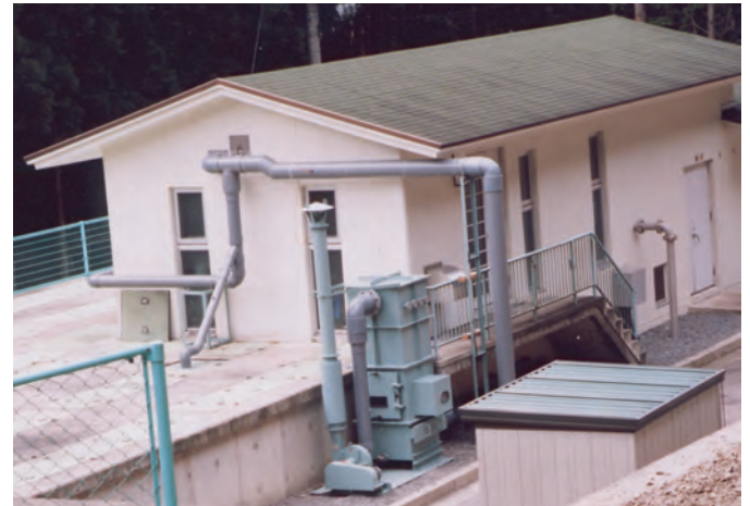
農業集落排水処理施設
