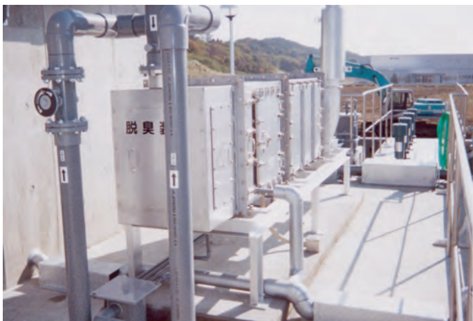
食品会社排水処理浄化槽施設
