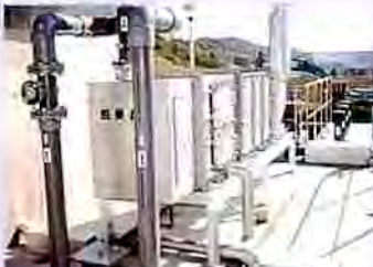
食品会社排水処理浄化槽施設 ADO-1000-A
